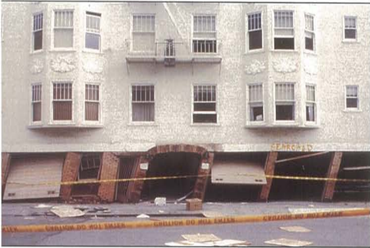
在十月舊金山大地震時，有“軟”的一層樓的建築物都有受到部分的損害。有些鄰近的建築物全部都被損害。
